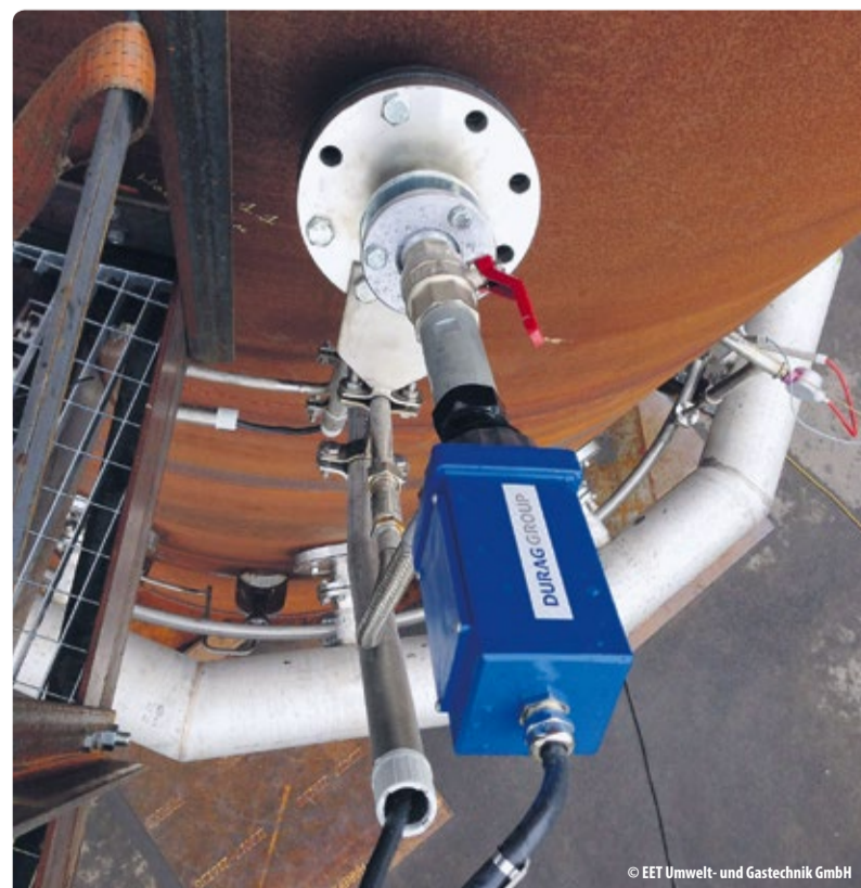
Ein Flammenwächter überwacht permanent die Farbe und Temperatur der Flamme, um die optimale Verbrennung der Prozessgase sicherzustellen
